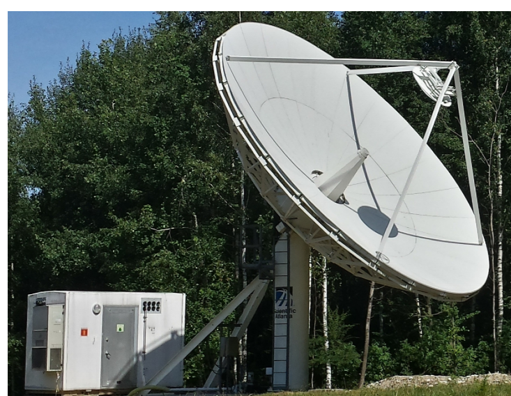
RT-9. Nadawczo odbiorcza paraboloidalna antena satelitarna o średnicy czaszy 9 m. Wyprodukowana w USA w roku 2000, zainstalowana w OAKJ w roku 2012.
